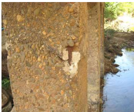
รูปที่ 3.4-11 เสาต่อม่อ สภาพเก่าผิวสีกร่อนมีดินกะเทาะบ้นถึงเหล็กเสริม ชั้นสนิมขุม
