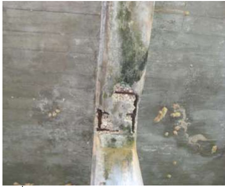
รูปที่ 3.4-25 ภาพขยาย ท้องคานหัวเสา คอนกรีตเสื่อมสภาพ กะเทาะเหล็กเสริมขึ้นสนิม
