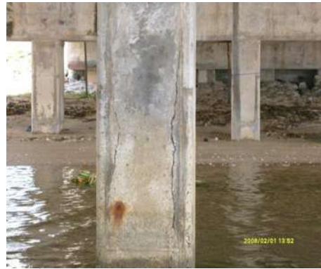
รูปที่ 3.4-40 เสาตอม่อ รั้วมูม ขนานขอบเสา รุนแรง
