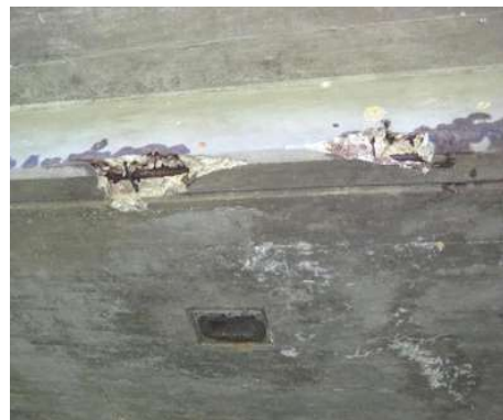
รูปที่ 2.4-18 คอนกรีตเสื่อม สภาพกะเทาะ หลุดล่อนเหล็กเสริมขึ้นสนิม
