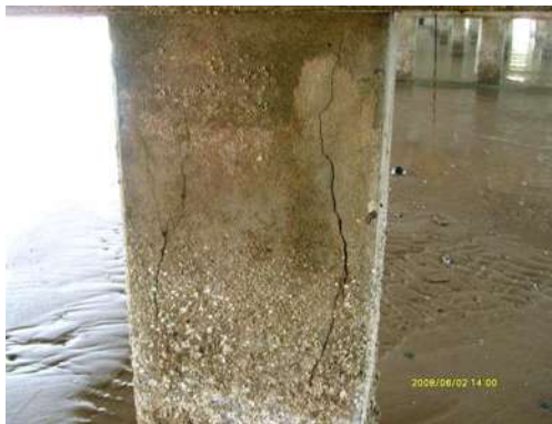
รูปที่ 4.3-1 ผิวคอนกรีตเสื่อม มีคราบชะล้างเหล็กเสริมชั้นสนิม คอนกรีตแตกร้าว
