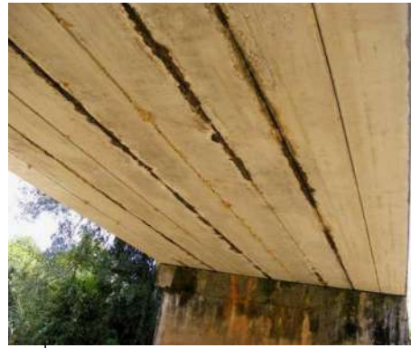
รูปที่ 2.4-26 มีคราบชะล้างรุนแรงมาก รอยต่อ ระหว่างแผ่นรั้วซีมของ BOX GIRDER
