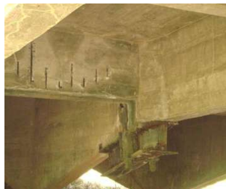
รูปที่ 2.3-12 คานขวาง T - GIRDER เหล็กปลอกขึ้นสนิมผิวคอนกรีตกะเทาะ
