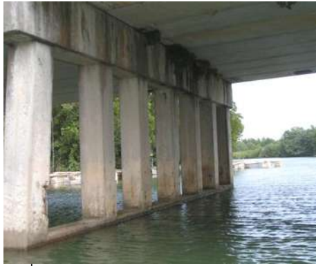
รูปที่ 3.4-37 เสาตอม่อ โคนเสารั้วมูม และ แตกกะเทาะ เหล็กเสริมขึ้นสนิม
