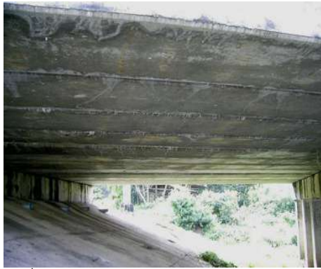
รูปที่ 2.2-9 มีคราบชะล้างระหว่างแผ่น PLANK GIRDER
