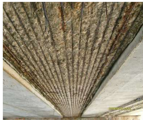
รูปที่ 2.5-2 แผ่นพื้น PLANK GIRDER บางแผ่น เหล็กเสริมถูกกัดกร่อนขึ้นสนิมจนหลุดล่อนหมดทั้ง แผ่น
