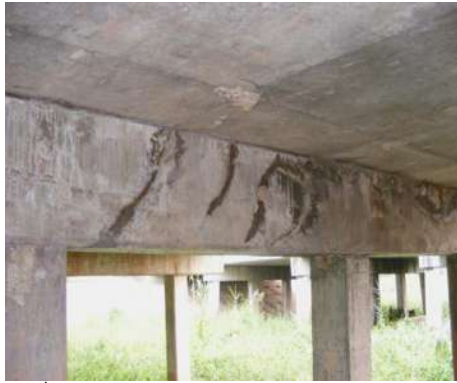
รูปที่ 3.5-9 คานหัวเสา รั่วเฉียง หลายรอย
