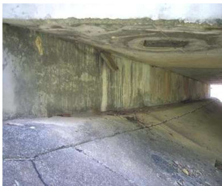
รูปที่ 3.2-11 คานหัวเสาซ้อนข้างเก่า และ มอดระบายน้ำ
