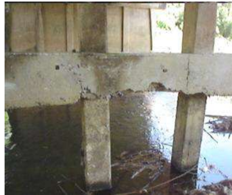
รูปที่ 3.3-16 คอนกรีตฝิวล่างคานยึดเสาแตก กะเทาะถึงเหล็กเสริมหลัก
