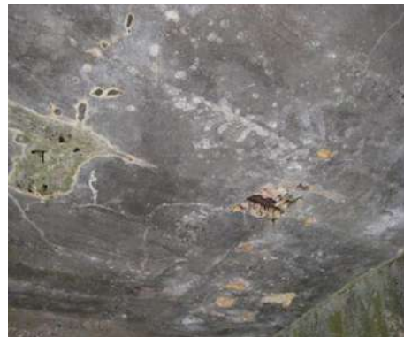
รูปที่ 2.4-4 คราบเก่ามากโฟรงเหล็กขึ้นสนิม และ เนื้อคอนกรีตเสื่อมสภาพ
