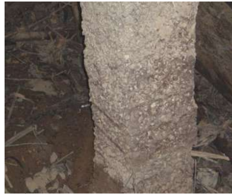
รูปที่ 3.4-10 โคนเสาสีกร่อนรุนแรงใกล้ถึงเหล็กเสริม
