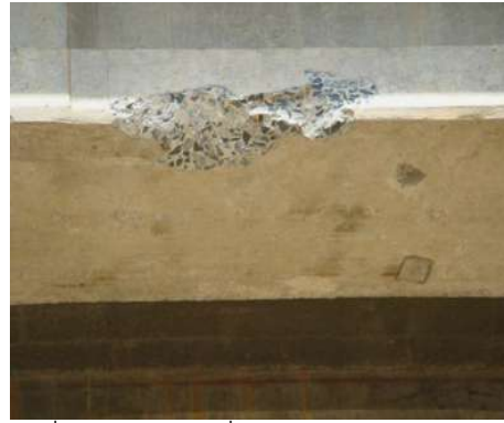
รูปที่ 2.2-14 ขอบบิ่นไม่ถึงเหล็กเสริม
