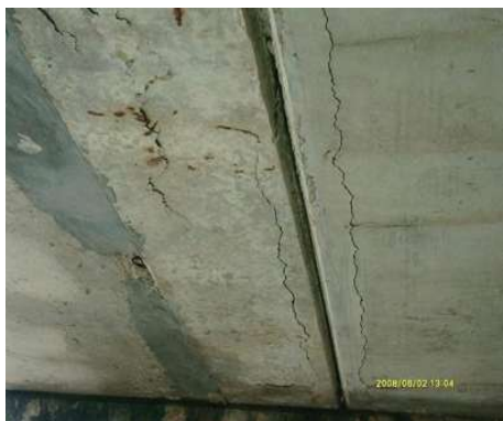
รูปที่ 2.4-23 แผ่นพื้น PLANK GIRDER ร้าวกว้างแนวขนานหลายรอย
