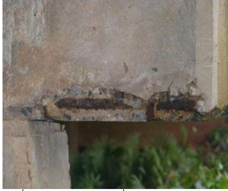
รูปที่ 3.3-13 ขอบคานยื่นด้านล้างคอนกรีต กะเทาะเหล็กขึ้นสนิม
