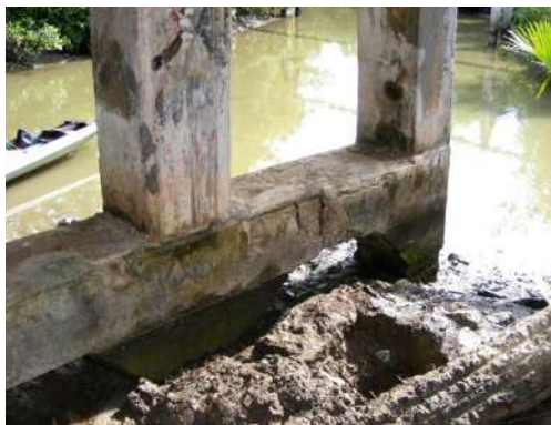
รูปที่ 4.2-3 มิวคอนกรีตเสื่อมสภาพ มีคราบชะล้างกระจาย คอนกรีตแตกกะเทาะ เหล็กเสริมขึ้นสนิม
