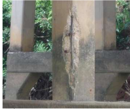
รูปที่ 3.4-2 ภาพขยาย คอนกรีตกะเทาะถึงเหล็กเสริม ขนาดใหญ่
