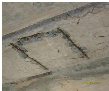
รูปที่ 2.4-24 แผ่นพื้น PLANK GIRDER คอนกรีตแตกกะเทาะเหล็กปลอกชั้นสนิมขุมและริมขอบร้าวในแนวขนาน
