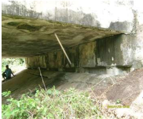
รูปที่ 6.3-1 ลาดผิวคอนกรีตหลุดตัว
