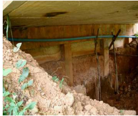
รูปที่ 6.5-8 ไม่มีลวดป้องกันคอสะพาน
