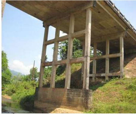
รูปที่ 3.2-1 เสาตอม่อและคานหัวเสาเก่า มีคราบชะล้างค่อนข้างรุนแรง
