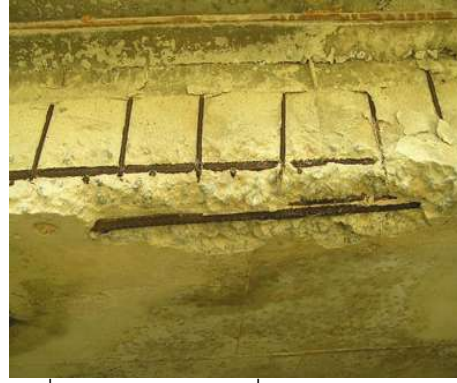
รูปที่ 2.4-14 คอนกรีตเสื่อมสภาพ หลุดแยก เนื้อเป็นแผ่นขนาดใหญ่ ช้างพื้นสะพาน
