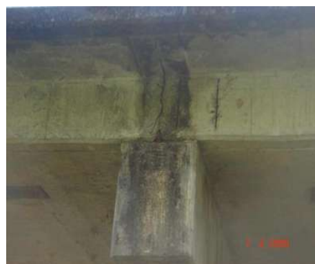
รูปที่ 2.2-18 มีคราบชะล้างที่รอยต่อพื้น และ ด้านข้างของพื้นคอนกรีตกะเทาะเหล็กปลอก ชั้นสนิม
