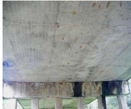
รูปที่ 2.2-4 คราบชะล้างและคราบสีเทาตามแนวเหล็กเสริม
