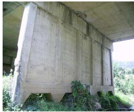
รูปที่ 3.3-22 เสาตอม่อชนิดกันซุง ถูกชนและกะเทาะถึงเหล็กเสริมหลักตรงที่มีกำแพงยึด
