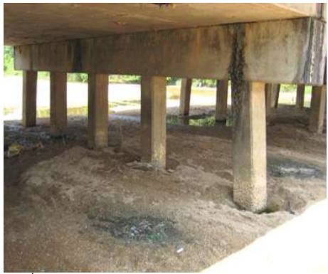
รูปที่ 3.3-21 โคนเสาเข็มกร่อนผิวดิน และมีรอยถูกกัดเซาะรอบเสา
