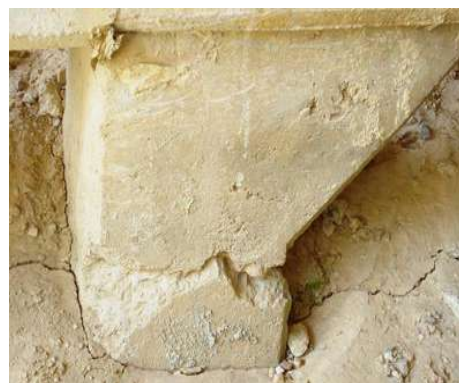
รูปที่ 3.3-12 จุดต่อเสา คอนกรีต กะเทาะไม่ ถึงเหล็ก
