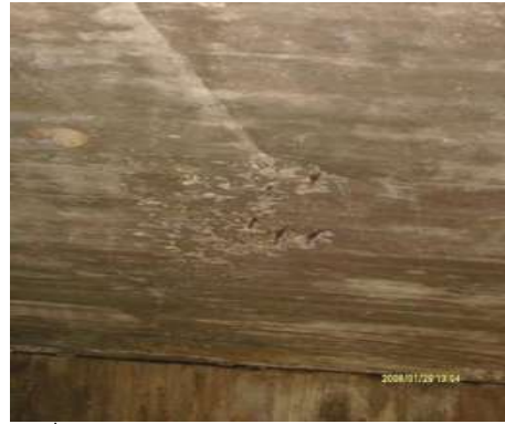
รูปที่ 2.4-16 โพรงเม็ดหินขนาดใหญ่ เหล็ก เสริมกลางสะพานขึ้นสนิม
