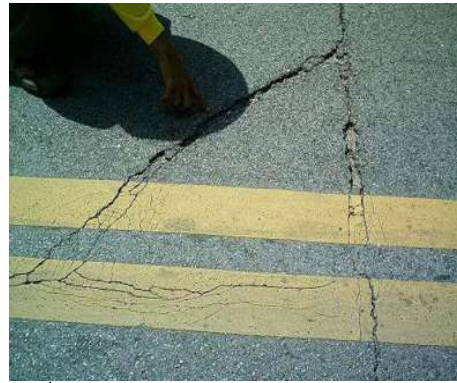
รูปที่ 1.3-20 คอนกรีตทับหน้าได้ผิวลาดยาง แตกกะเทาะที่มุมริม
