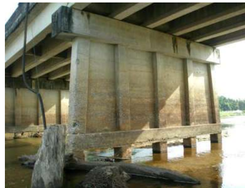
รูปที่ 4.1-12 มุมเสาตูกสิ่งลอยน้ำชนแตกบิ่นและตอม่อตีกกร่อนเนื่องจากน้ำกัดเซาะ
