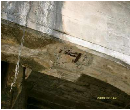
รูปที่ 2.4-25 คอนกรีตคานกะเทาะ เหล็กเสริม ขึ้นสนิมผู้ ได้คานยื่นของสะพาน T GIRDER
