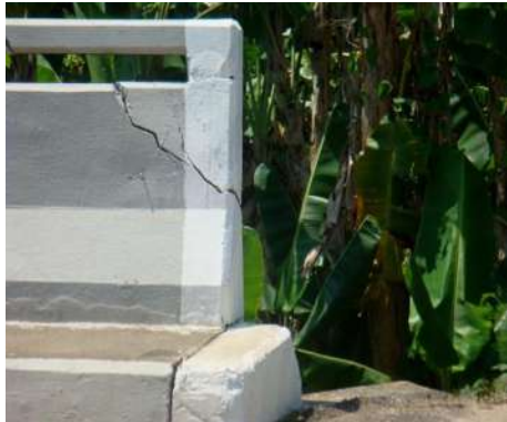
รูปที่ 5.3-1 มุมริมราวทางเท้า ถูกชนหัก
