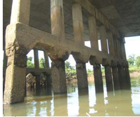
รูปที่ 3.4-16 จุดต่อท่อนกรีตเสาตอม่อสี่เหลี่ยมเป็นโพรงขนาดเล็ก บางแห่งถึงเหล็กเสริม
