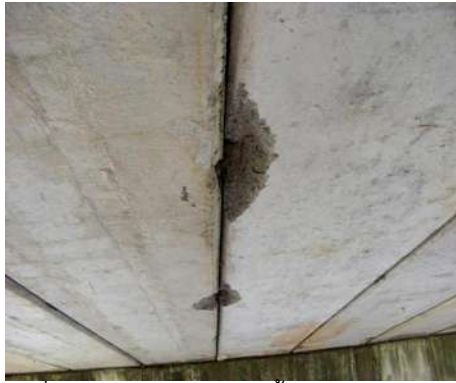
รูปที่ 2.3-7 ขอบล่างแผ่นพื้น PLANK GIRDER แตกกะเทาะถึงเหล็ก
