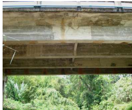
รูปที่ 2.3-10 สะพาน T GIRDER ผิวมีคราบชะล้างมีคราบเกลือคองข้างรุนแรงที่คานสะพาน และคอนกรีตเสื่อมสภาพที่ปีกพื้นทางเท้า
