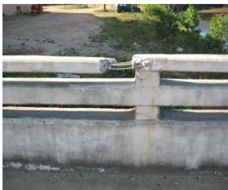
รูปที่ 5.3-3 คานบนสุด ทางเท้า TYPE 3 แตกหัก
