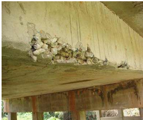
รูปที่ 2.3-21 ขอบล่างพื้น SLAB TYPE แตกกะเทาะ เหล็กเสริมสภาพดี
