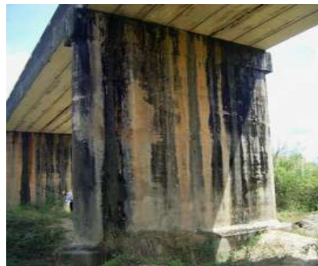
รูปที่ 3.2-12 ตอม่อกำแพง มีมอดระบายน้ำรุนแรง
