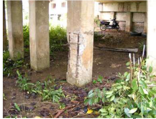
รูปที่ 4.2-8 คอนกรีตแตกกะเทาะเหล็กเสริมขึ้นสนิม
