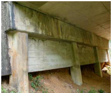
รูปที่ 6.5-1 ลาดดินทรุดต่ำมาก เป็นช่องเปิด ราวได้ผนังกันดิน
