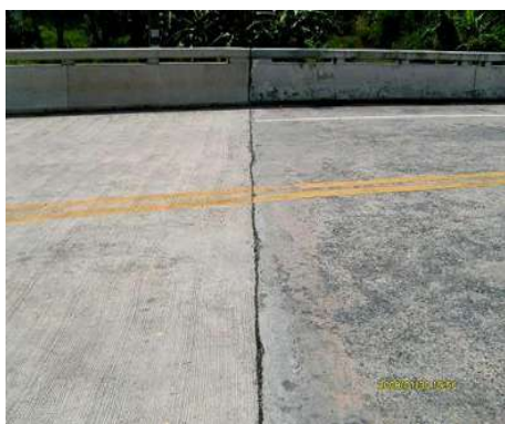
รูปที่ 1.4-13 ผิวสะพานส่วนต่อความยาว สภาพดี ระดับ 5 และสะพานเดิมสภาพชำรุด ระดับ 2
