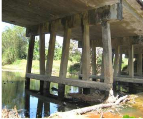
รูปที่ 3.4-15 โคนเสาตอม่อสี่เหลี่ยมที่ทรุดตัวลงเนื่องจากดินถูกขุดลอก เสริมถูกชนแตกกะเทาะ เหล็กเสริมขึ้นสนิม
