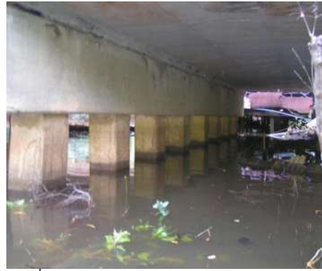
รูปที่ 3.4-38 เสาตอม่อ คอเสารั้วมูม ขนาน ขอบเสาทุกต้น
