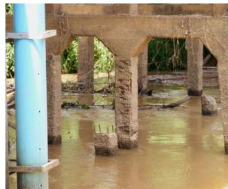
รูปที่ 3.5-6 เสาตอม่อสึกกร่อนเป็นโพรง ถึงเหล็กเสริมเป็นสนิม
