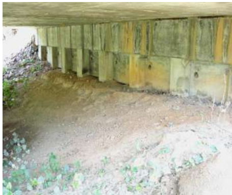
รูปที่ 6.4-3 ลาดดินต่ำกว่ำระดับชายผนังกันดิน
