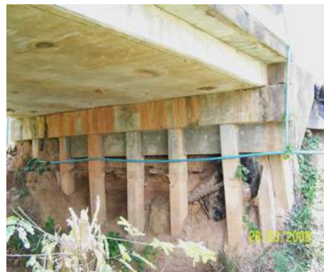
รูปที่ 3.4-18 ดินคอสะพาน ถูกกัดเซาะรุนแรงมากทำให้เสาตอม่อต้องรับแรงดันดิน
