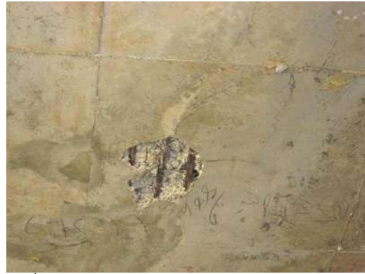
รูปที่ 2.3-20 คอนกรีตกะเทาะหลุดล่อน ขนาดค่อนข้างใหญ่ เหล็กเสริมเป็นสนิมผิว
