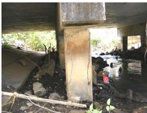
รูปที่ 4.3-3 เหล็กเสริมชั้นสนิม คอนกรีตแตกร้าว
