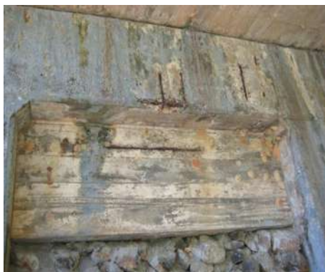
รูปที่ 3.4-23 เสาตอม่อริมมีคราบชะล้างรุนแรง คอนกรีตเสื่อมสภาพ กะเทาะเหล็กปลอกขึ้นสนิม
