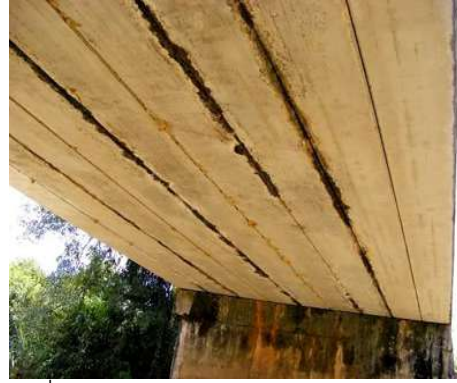
รูปที่ 1.4-16 ลักษณะด้านล่างของ BOX GIRDER ที่ด้านบนเป็นร่องแตกร้าว
