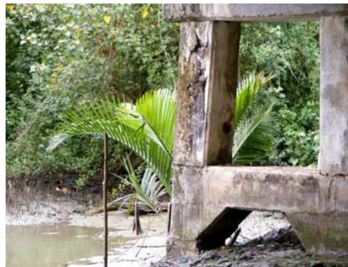
รูปที่ 4.2-4 มิวคอนกรีตเสื่อมสภาพ มีคราบชะล้าง คอนกรีตร้าวกะเทาะ
