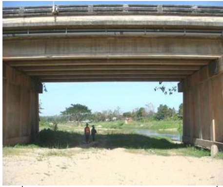
รูปที่ 2.2-13 I - GIRDER ถูกชน ขอบล่างบิ่น ไม่ถึงเหล็กเสริม
