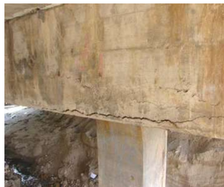
รูปที่ 3.4-42 คานหัวเสา รั้วมูม ขนาน คานล่าง สภาพใกล้กะเทาะ
