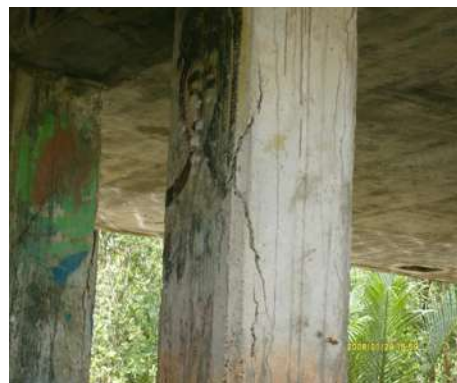
รูปที่ 3.4-36 เสาตอม่อ มุมรั้วกว้าง ตามแนวยาว
