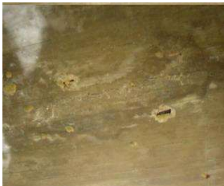
รูปที่ 2.4-3 คอนกรีตกะเทาะ เหล็กขึ้นสนิมผุ หลายแห่ง ในบริเวณคราบชะล้าง กลางสะพาน เนื้อคอนกรีตมีลักษณะเสื่อมสภาพ
