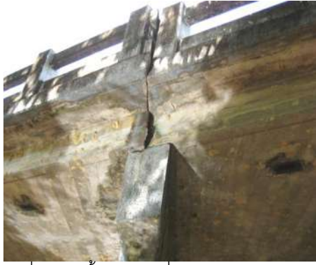
รูปที่ 4.13 พื้นสะพานเลื่อนเลยหัวคานรองรับ
