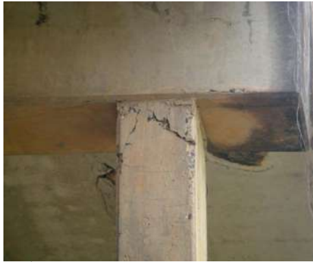
รูปที่ 3.4-9 คอเสาแตกร้าว
