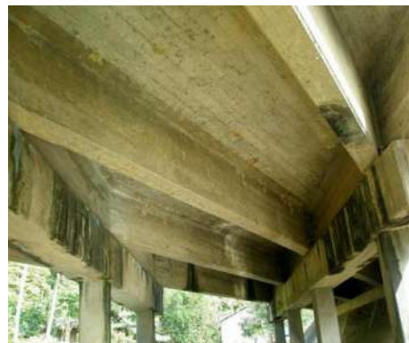
รูปที่ 2.2-12 T - GIRDER สภาพผิวดูเก่า
