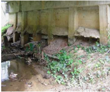
รูปที่ 6.5-7 หินเรียงถูกรัดเชาะหาย ไม่มี ลวดป้องกันคอสะพาน
