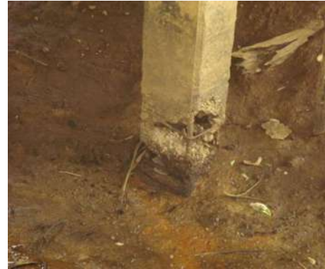
รูปที่ 3.5-2 เสาตอม่อ จุดต่อเทคอนกรีต ถูกกัดเซาะเป็นโพรงขนาดใหญ่ สูญเสียหน้าตัดเหล็กขึ้นสนิมขุม
