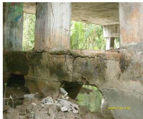
รูปที่ 3.4-30 เสาตอม่อ ร้าวเหล็กเสริมขึ้นสนิม คานยึดเสา ฝิวคอนกรีตแตกกะเทาะ เหล็กเสริมขึ้นสนิมผูกก่อนรุนแรง
