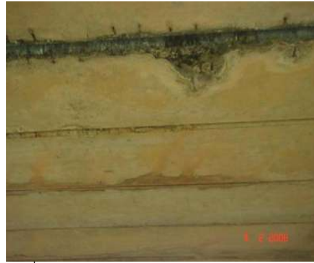
รูปที่ 2.3-8 มีคราบชะล้างรุนแรงระหว่างแผ่นพื้น PLANK GIRDER
