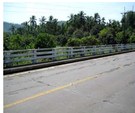
รูปที่ 1.4-14 ผิวลาดยางแตกร้าวเป็นร่องตาม แนวรอยต่อแผ่น BOX - GIRDER
