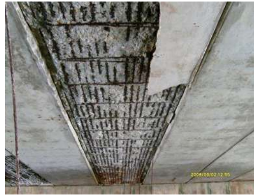
รูปที่ 4.3-12 ผิวคอนกรีตเสื่อมสภาพ คอนกรีตเสื่อมหลุดล่อนเป็นแผ่น (Delamination) เหล็กเสริมผุกร่อน
