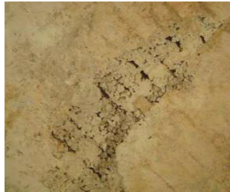
รูปที่ 2.4-2 ภาพขยายโฟรงเม็ดหิน ที่เห็นเหล็ก เสริม
