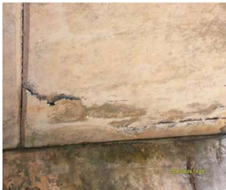
รูปที่ 2.3-17 พื้น PLANK GIRDER เหล็กขึ้นสนิม ร้าวกะเทาะใกล้คานรองรับพื้น
