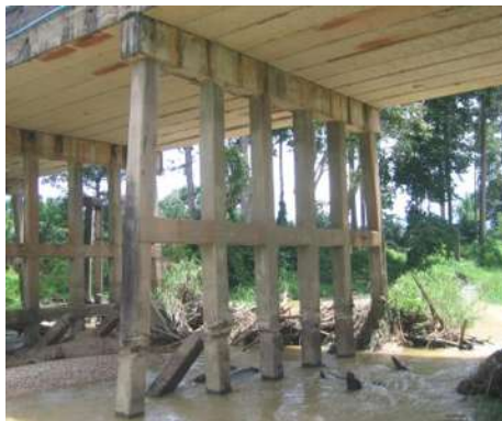
รูปที่ 3.4-3 จุดต่อแทคอนกรีตเสาตอม่อ สึกเป็นโพรงเว้าถึงเหล็กเสริม ขึ้นสนิม
