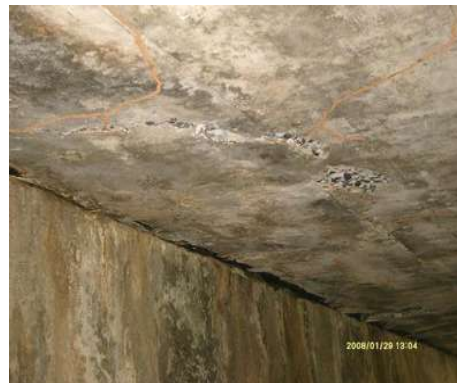
รูปที่ 2.3-18 พื้น SLAB TYPE เหล็กขึ้นสนิม ร้าวกะเทาะใกล้คานรองรับพื้น
