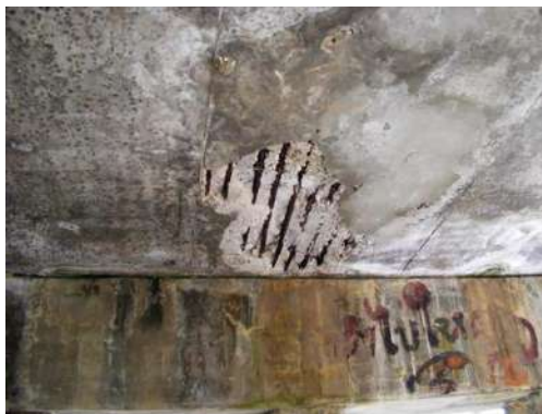
รูปที่ 4.2-11 คอนกรีตเสื่อมหลุดล่อนเป็นแผ่น (Delamination) เหล็กเสริมขึ้นสนิม มีคราบชะล้างกระจาย
