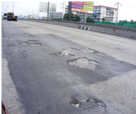
รูปที่ 1.5-1 คอนกรีตทับหน้า แตกกะเทาะเสียหายเป็นบริเวณกว้าง เทปิดทับด้วยผิวลาดยาง
