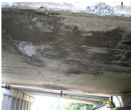
รูปที่ 2.2-5 ผิวคอนกรีตเก่าสีเข้มและขอบพื้นถูกชนแตกบิ่นขนาดเล็ก
