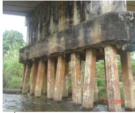
รูปที่ 3.3-20 ตอม่อกำแพง มีคราบชะล้างรุนแรง และห้องคลองถูกกัดเซาะ เสาตอม่อชำรุด เห็นเสาเข็มลึกกร่อนผิวดิน
