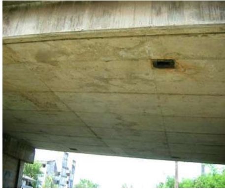
รูปที่ 2.2-1 ผิวคอนกรีตข้างเก่า และมีคราบชะล้าง
