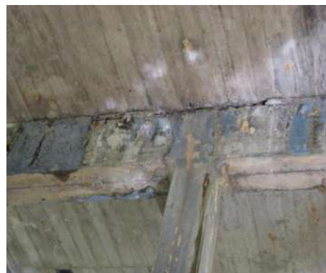
รูปที่ 3.4-24 คานหัวเสา ตอม่อกลางมีคราบชะล้างรุนแรง ปาคานแตกกะเทาะถึงเหล็กเสริมขึ้นสนิม
