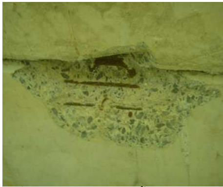
รูปที่ 2.4-21 ขอบล่างแผ่นพื้น PLANK GIRDER แตกกะเทาะถึงเหล็กเสริมขนาดใหญ่
