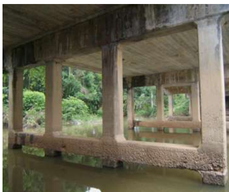
รูปที่ 3.4-5 โคนเสาตอม่อสึกกร่อน ผิวหिनบาง เป็นโพรงและเหล็กเสริมขึ้นสนิม
