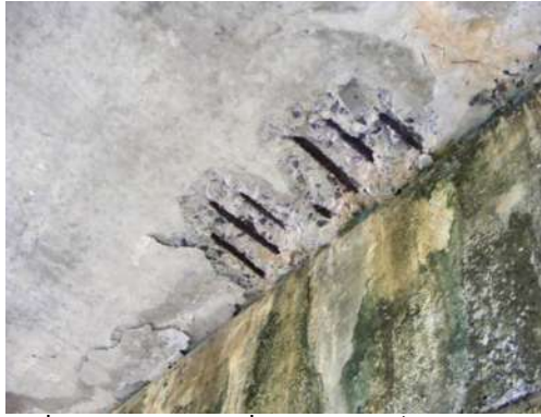
รูปที่ 4.2-13 คอนกรีตเสื่อมหลุดล่อนเป็นแผ่น (Delamination) เหล็กเสริมชั้นสนิม มีคราบชะล้างกระจาย
