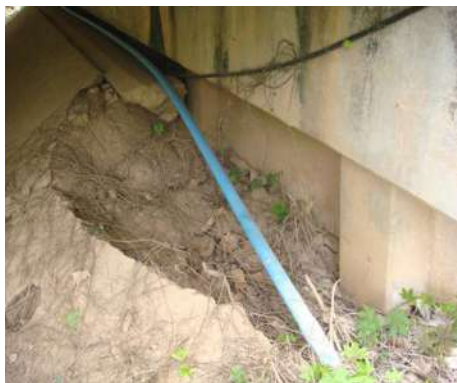
รูปที่ 6.3-5 ผิวคอนกรีตถูกขูด
