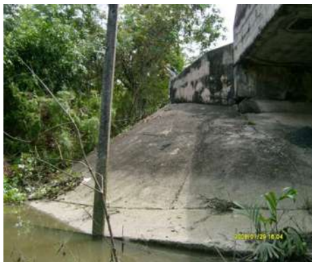
รูปที่ 6.2-5 ลาดผิวคอนกรีต ขยาล่างถูกกัดเซาะหลุดตัว
