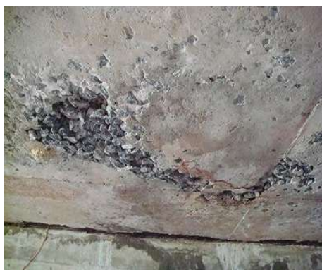
รูปที่ 2.3-23 โฟรงขนาดใหญ่ ไม่เห็นเหล็กใกล้คานรองรับพื้น
