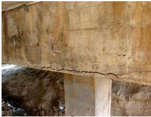
รูปที่ 4.3-5 เหล็กเสริมชั้นสนิม คอนกรีตแตกร้าว
