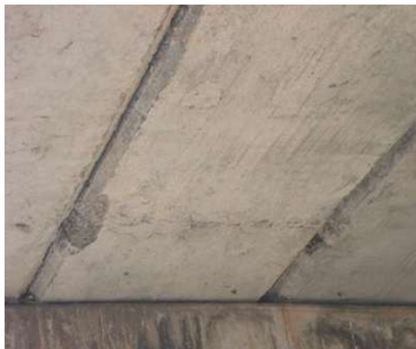
รูปที่ 2.2-15 ขอบล่าง PLANK GIRDER แตกบิ่นไม่ถึงเหล็กเสริม
