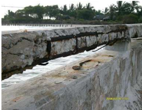
รูปที่ 4.3-13 ผิวคอนกรีตเสื่อมสภาพเหล็กเสริมผุกร่อน
