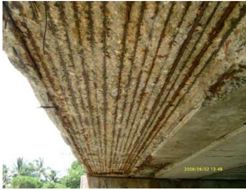
รูปที่ 4.3-11 ผิวคอนกรีตเสื่อมสภาพ คอนกรีตเสื่อมหลุดล่อนเป็นแผ่น (Delamination) เหล็กเสริมผุกร่อน
