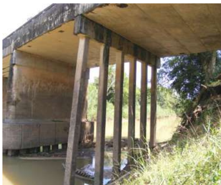
รูปที่ 3.4-17 เสาตอม่อ PILE BENT ทรุดตัวลงเนื่องจากดินที่ถูกลบออก
