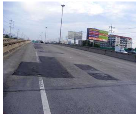
รูปที่ 1.5-2 คอนกรีตทับหน้า แตกกะเทาะเสียหายเป็นบริเวณกว้าง เทปิดทับด้วยผิวลาดยาง
