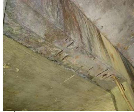
รูปที่ 3.3-14 ฝิวล่างคานหัวเสา คอนกรีตกะเทาะ เหล็กปลอกขึ้นสนิม
