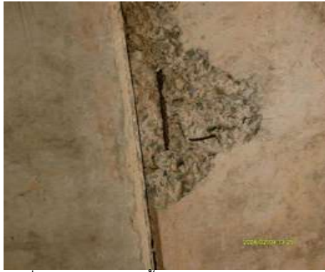
รูปที่ 2.3-15 เหล็กขึ้นสนิม แดกกะเทาะบริเวณ ช่องระบายน้ำของแผ่นพื้น PLANK GIRDER
