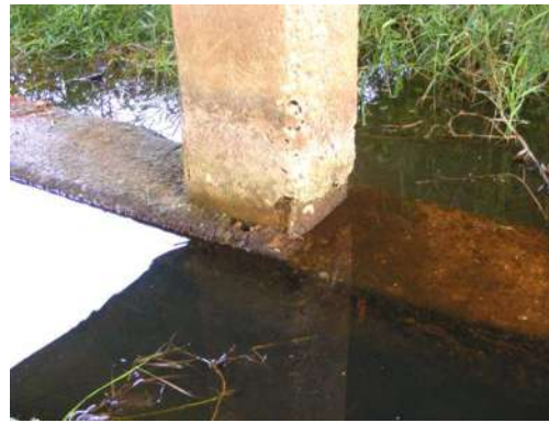
รูปที่ 4.1- 2 คราบเสื่อมสภาพและผิวสีกร่อนคอนกรีต
