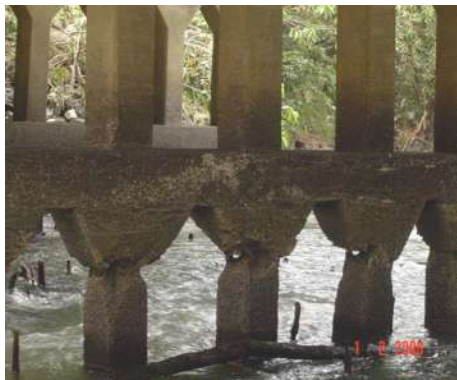
รูปที่ 3.5-3 จุดต่อเทคอนกรีต เสาตอม่อสึกกร่อนเป็นโพรง สูญเสียหน้าตัด
