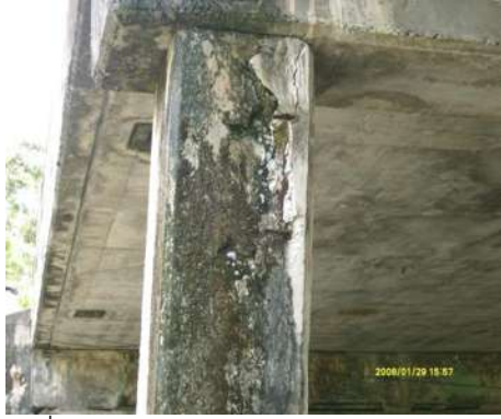
รูปที่ 3.4-31 เสาตอม่อ มีคราบชะล้างรุนแรง ผิวคอนกรีตแตกร้าว เหล็กปลอกขึ้นสนิม
