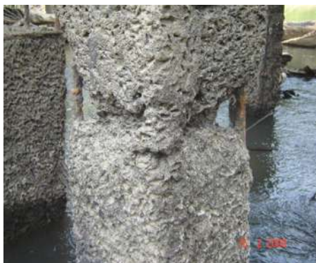
รูปที่ 3.5-5 เสาตอม่อสึกกร่อนเป็นโพรง สูญเสียหน้าตัดเหล็กเสริมเป็นสนิมขุม
