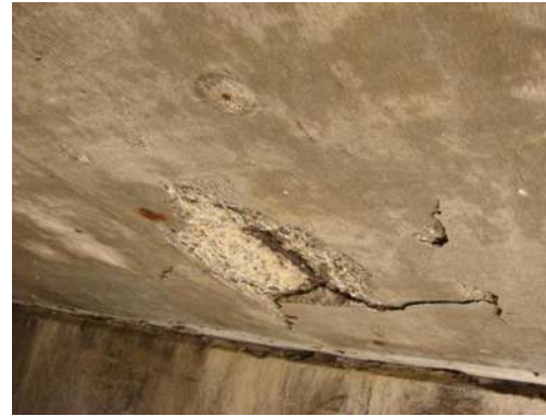
รูปที่ 4.3-8 คอนกรีตร้าวกะเทาะ เหล็กเสริมชั้นสนิม
