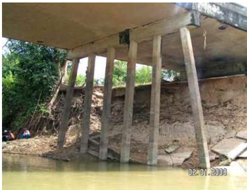
รูปที่ 4.1-11 ลาดคอสสะพานถูกกัดเซาะหักพังเสาตอม่อและชะลูดผิวตีกกร่อนผิดมาตรฐาน
