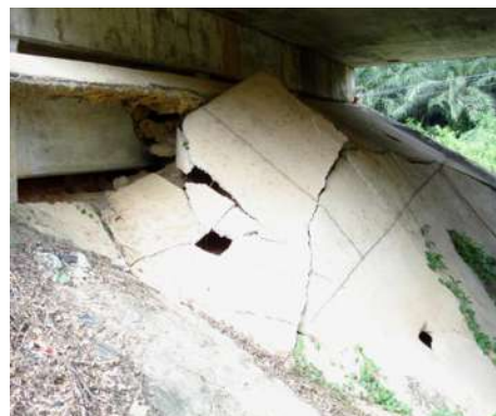
รูปที่ 6.5-4 ผิวคอนกรีต แตกร้าวหลุดตัวมาก
