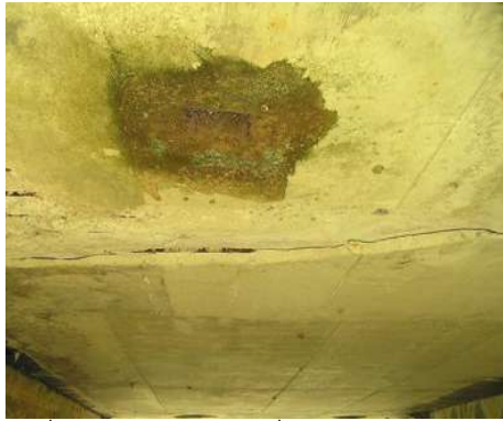
รูปที่ 2.4-15 คอนกรีตเสื่อมสภาพหลุดแยกเนื้อ เป็นแผ่น
