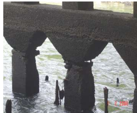
รูปที่ 3.5-4 จุดต่อเทคอนกรีต เสาตอม่อสึกกร่อนเป็นโพรงสูญเสียหน้าตัด
