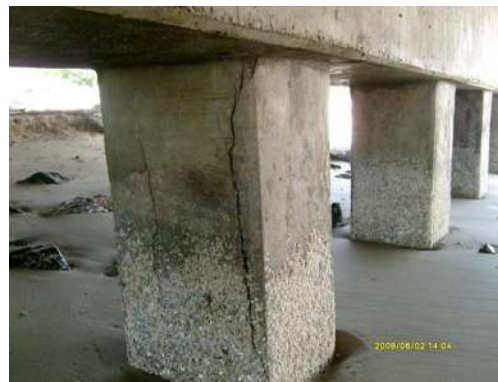
รูปที่ 4.3-2 ผิวคอนกรีตเสื่อม มีคราบชะล้างเหล็กเสริมชั้นสนิม คอนกรีตแตกร้าว
