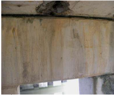
รูปที่ 3.2-9 คานหัวเสาที่มีรอยรั่วเส้นผม แนวขวางกลางคานหัวเสา
