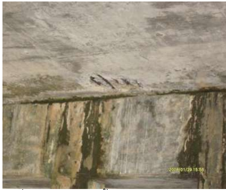
รูปที่ 2.3-19 เหล็กขึ้นสนิม คอนกรีตค่อนข้างใหญ่ กะเทาะใกล้คานรองรับพื้น
