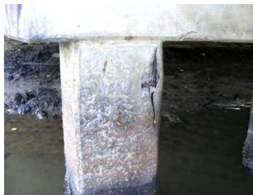
รูปที่ 4.2-6 คอนกรีตร้าวกะเทาะ เหล็กเสริมขึ้นสนิม
