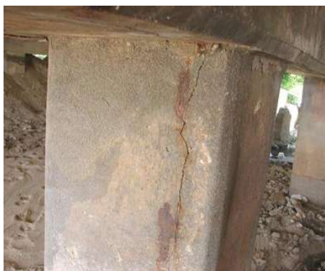
รูปที่ 3.3-11 คอเสา ร้าวมุม
