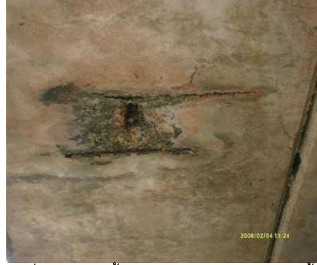
รูปที่ 2.3-16 พื้น PLANK GIRDER เหล็กขึ้น สนิมแดกกะเทาะใกล้คานรองรับพื้น
