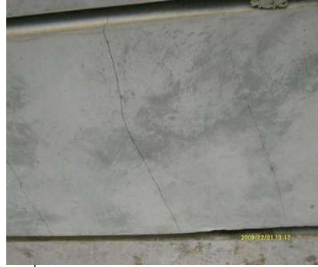
รูปที่ 2.4-20 รอยร้าวกว้างและมีรอยร้าวเส้นผมแนวขวางกลางพื้น PLANK GIRDER
