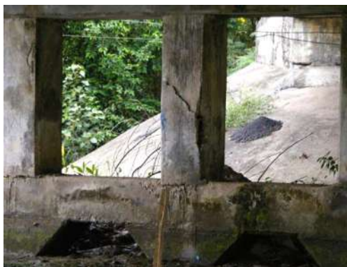
รูปที่ 4.2-5 มิวคอนกรีตเสื่อมสภาพ คอนกรีตร้าวกะเทาะ
