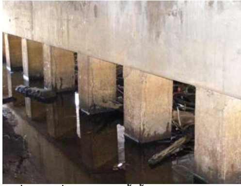
รูปที่ 4.2-7 เนื่องจากระดับน้ำขึ้นลง ทำให้เสา ตอม่ออื้อรา เนื่องจากเหล็กเสริมขึ้นสนิม
