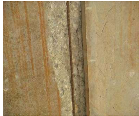
รูปที่ 2.4-22 ขอบริมแผ่นพื้นกะเทาะเป็นแนวยาว ลวดอัดแรงเส้นริมไม่มีเนื้อคอนกรีตหุ้ม
