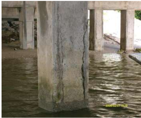
รูปที่ 3.4-39 เสาตอม่อ รั้วมูม ขนานขอบเสา สภาพใกล้กะเทาะ
