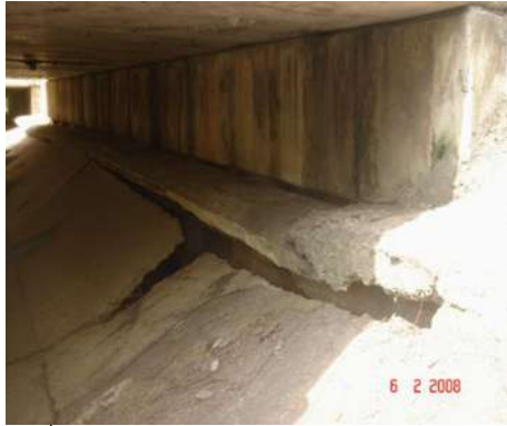
รูปที่ 6.4-1 ฝิวคองกรีต ทรุด้ตัว แยกดินเป็นโพรง
