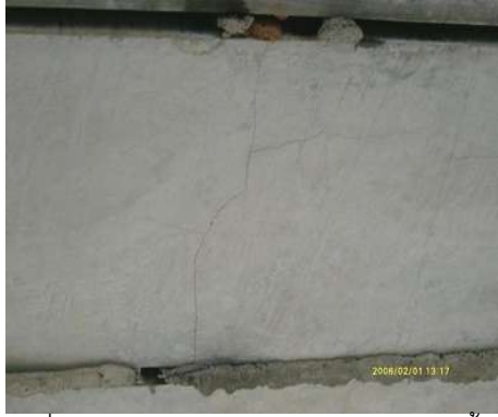
รูปที่ 2.4-19 รอยร้าวแนวขวางกลางแผ่นพื้น PLANK GIRDER หลายรอย
