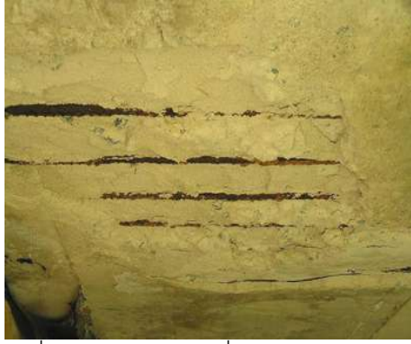
รูปที่ 2.4-13 คอนกรีตเสื่อมสภาพหลุดแยกเนื้อ เป็นแผ่นเหล็กขึ้นสนิมผุ ไก่คานรองรับพื้น
