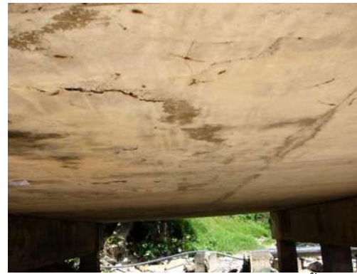
รูปที่ 4.3-6 คอนกรีตเสื่อมสภาพเหล็กเสริมชั้นสนิม คอนกรีตแตกร้าว
