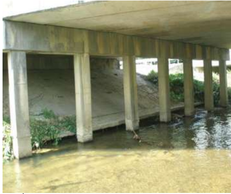
รูปที่ 6.2-1 ลาดผิวคอนกรีต สภาพขยาล่าง ถูกกัดเซาะ
