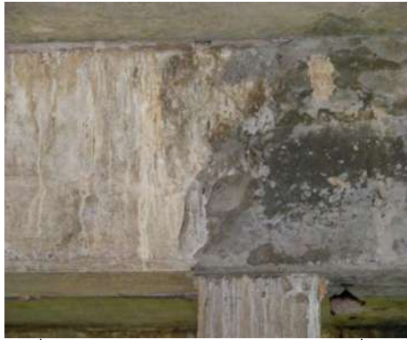
รูปที่ 4.9 รอยร้าวขวางบนหัวเสาด้านใน ที่ไม่ทาด
