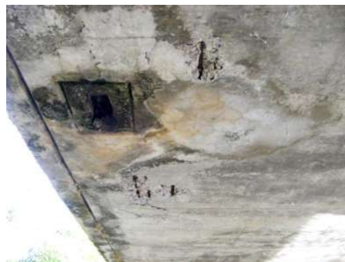
รูปที่ 4.2-12 คอนกรีตเสื่อมหลุดล่อนเป็นแผ่น (Delamination) เหล็กเสริมขึ้นสนิม มีคราบชะล้างกระจาย
