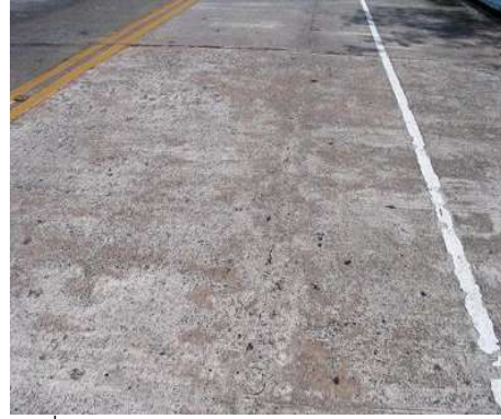
รูปที่ 1.3-12 สึกเป็นหย่อมผิวหิน ร้าวหดตัว และกะเทาะตามแนวเหล็กเสริมฝังผิวบน
