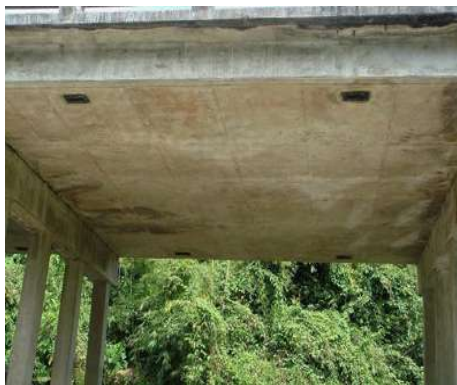
รูปที่ 2.3-3 คราบชะล้างใกล้คานรองรับและ หย่อมโพรงดินไม่ถึงเหล็กเสริม
