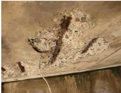
รูปที่ 4.3-7 คอนกรีตแตกกะเทาะ เหล็กเสริมชั้นสนิม
