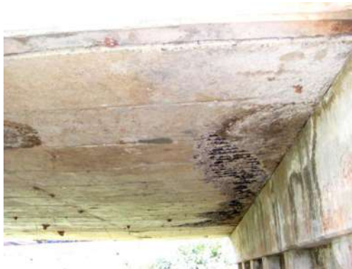
รูปที่ 4.2-9 คอนกรีตเสื่อมหลุดล่อนเป็นแผ่น (Delamination) เหล็กเสริมขึ้นสนิม
