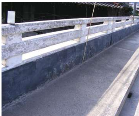
รูปที่ 5.2-1 ราวทางเท้า สภาพเก่า คอนกรีต ราวส่วนล่าง กะเทาะขนาดเล็กหลายแห่ง
