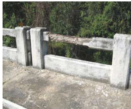
รูปที่ 5.4-4 ราวสภาพเก่า คอนกรีตคานบนแตก กะเทาะถึงเหล็ก
