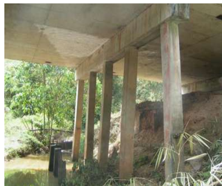
รูปที่ 3.3-6 เสาตอม่อชะลูดจากดินทำนองคลองถูกน้ำกัดเซาะ
