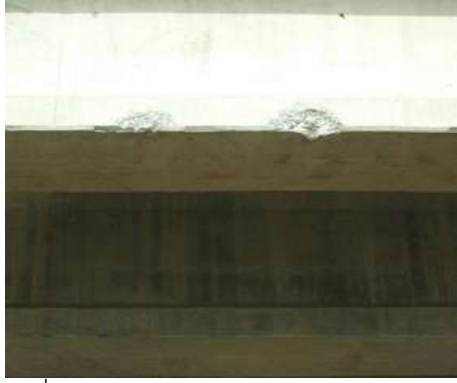
รูปที่ 2.3-13 ขอบล่างคาน I - GIRDER แตกบิ่น
