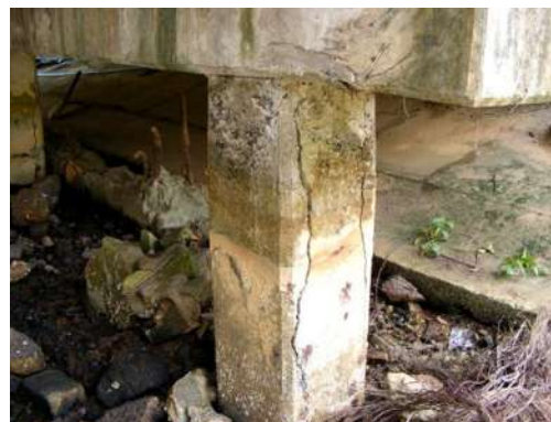
รูปที่ 4.3-4 เหล็กเสริมชั้นสนิม คอนกรีตแตกร้าว
