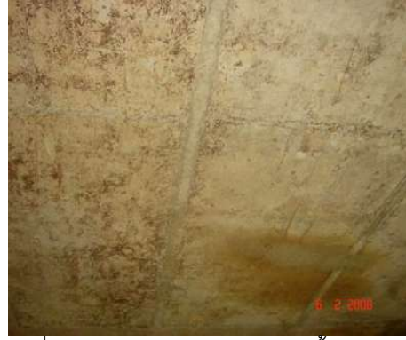
รูปที่ 2.2-8 ผิวเป็นคราบเก่า ท้องพื้น PLANK GIRDER
