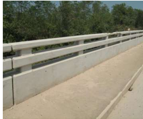
รูปที่ 5.3-2 คานบนสุด ทางเท้า TYPE 3 แตก กะเทาะ
