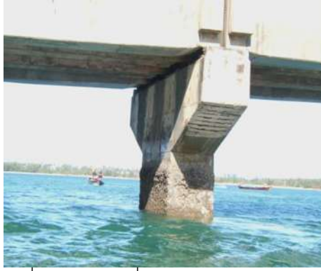
รูปที่ 3.4-43 คานยื่น หัวเสาตอม่อขนาดใหญ่ กลางทะเล คอนกรีตผิวล้าง เสื่อมสภาพหลุด แยกเนื้อเป็นแผ่นเหล็กปลอกขึ้นสนิมผุ
