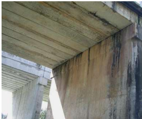
รูปที่ 2.3-9 มีคราบชะล้างระหว่าง BOX GIRDER
