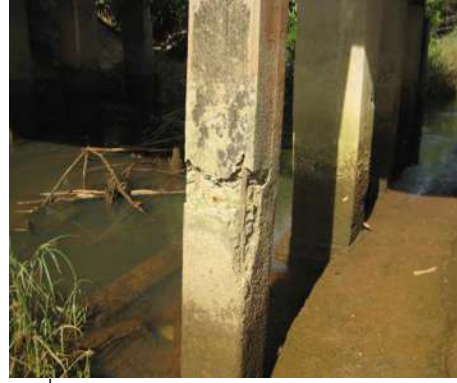
รูปที่ 3.4-8 เสาต่อม่อถูกชนแตกกะเทาะเหล็กเสริมชั้นสนิม
