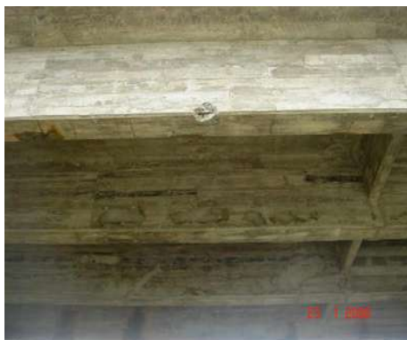
รูปที่ 2.3-11 ขอบล่างคาน T - GIRDER แตกบิ่นถึงเหล็ก
