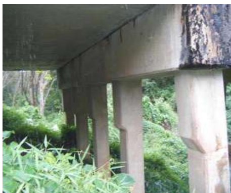
รูปที่ 3.3-17 เสาก่อสร้างเอียงศูนย์
