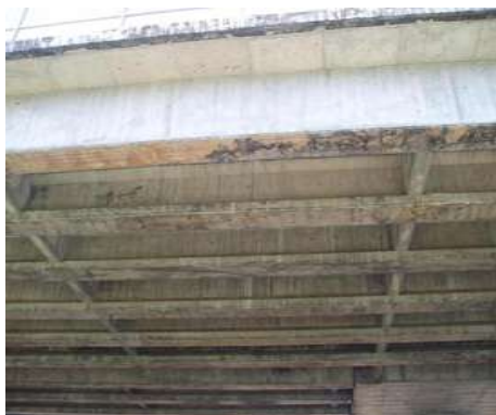
รูปที่ 2.2-11 I - GIRDER มีคราบเก่า และคราบชะล้างค่อนข้างรุนแรง
