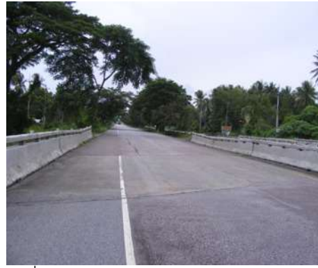
รูปที่ 4.16 สะพานทรุดตัวมาก ชำรุด ระดับ 1 (ที่ประจวบคีรีขันธ์)
