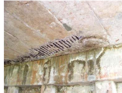
รูปที่ 4.2-10 คอนกรีตเสื่อมหลุดล่อนเป็นแผ่น (Delamination) เหล็กเสริมขึ้นสนิม มีคราบชะล้างกระจาย
