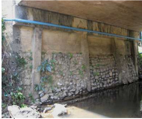
รูปที่ 3.4-19 เสาตอม่อริม ไม่มีลาดดินป้องกันคอสะพาน ทำให้ต้องรับแรงดันดินป้องกัน
