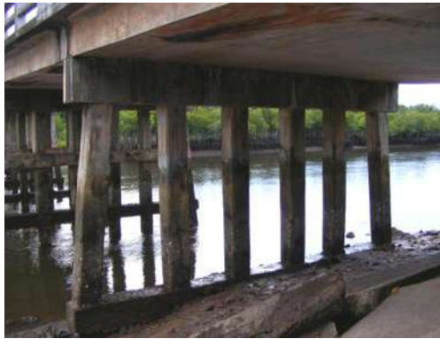
รูปที่ 4.2-1 มิวคอนกรีตเสื่อมสภาพ คอนกรีตแตกกะเทาะ เหล็กเสริมขึ้นสนิม
