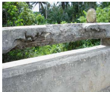
รูปที่ 5.3-4 คานบน ราว TYPE 1 แตกกะเทาะถึง เหล็ก
