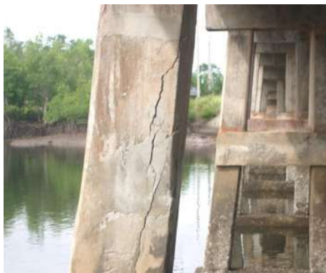
รูปที่ 3.4-35 เสาตอม่อรั้วกว้าง ตามแนวยาว ขนานขอบเสา
