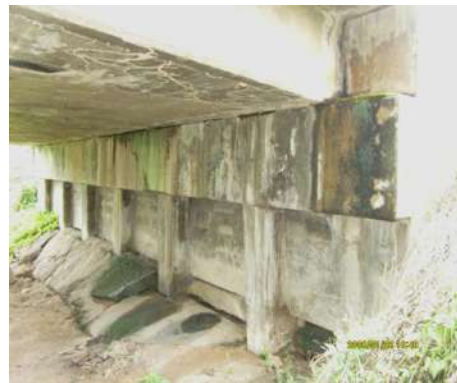
รูปที่ 6.4-4 ลาดดินที่ซ่อมด้วคองกรีตทรุด้ตัวและแตกหัก ระดับต่ำกว่ำชายผนังกันดิน
