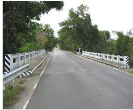
รูปที่ 4.10 สะพานเลื่อนมานอกแนว SPAN ที่ 1 กับ SPAN ที่ 2
