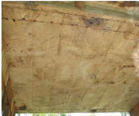
รูปที่ 2.4-1 คราบดินคราบชะล้าง โฟรงเม็ดหิน ขนาดใหญ่ ที่เห็นถึงเหล็กเสริมหลายแห่ง
