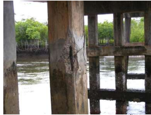
รูปที่ 4.2-2 คอนกรีตแตกกะเทาะ เหล็กเสริมขึ้นสนิม
