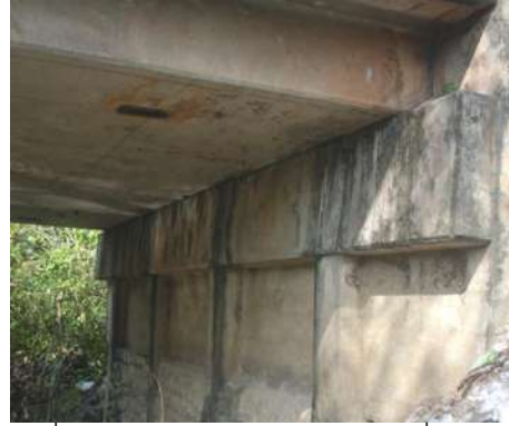
รูปที่ 3.4-20 ภาพมุมข้าง ตอม่อริม ที่รับแรงดันดินสังเกตเห็นคานหัวเสาเอียงทำมุมแนวตั้งจากแรงดันดิน
