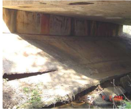
รูปที่ 6.4-2 ชายล้งฝิวคองกรีตทรุด้ตัว แยก
