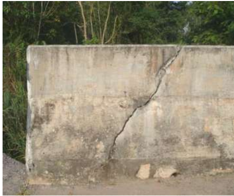
รูปที่ 5.4-5 ราว BARRIER ถูกชน รั้วหัก
