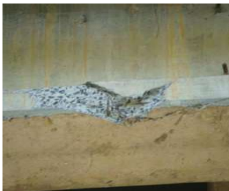
รูปที่ 2.4-17 ขอบล่าง คาน I GIRDER ถูกชน แตกร้าวถึงเหล็กเสริม
