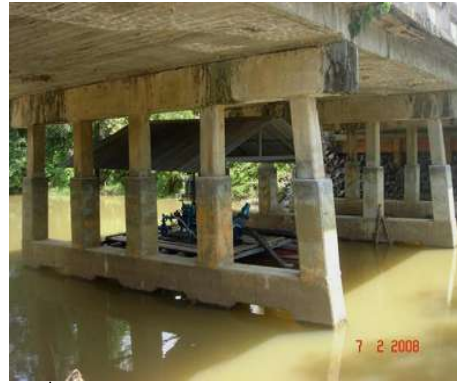
รูปที่ 3.2-2 มีคราบชะล้าง คานหัวเสาเชื่อมค่อนข้างพอกโคนเสา
