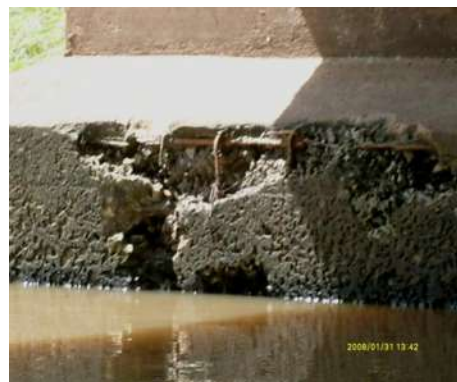
รูปที่ 3.4-12 ฐานรากใหญ่ สีกร่อนเป็นโพรงขนาดใหญ่ ถึงเหล็กเสริม
