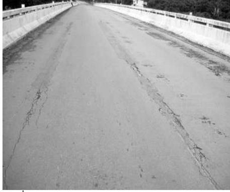
รูปที่ 1.4-15 ผิวลาดยางแตกร้าวเป็นร่องตามแนวรอยต่อแผ่น BOX GIRDER
