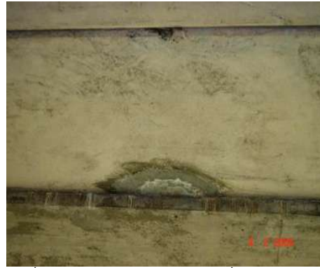
รูปที่ 2.2-10 คราบคอนกรีตเปลี่ยนสีตามแนว รอยร้าวที่จะกะเทาะของ SHEAR KEY
