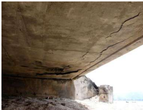
รูปที่ 4.3-9 คอนกรีตเสื่อมหลุดล่อนเป็นแผ่น (Delamination)
